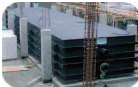
Zbiornik buforowy wody basenowej
