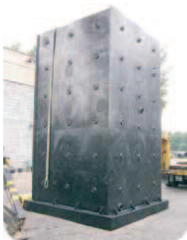
Pompownia - zbiornik w systemie PE - beton - PE
