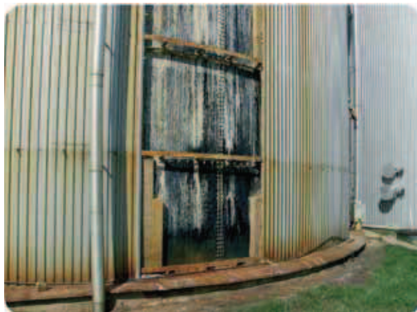
Wycieki powstałe w stalowym zbiorniku
